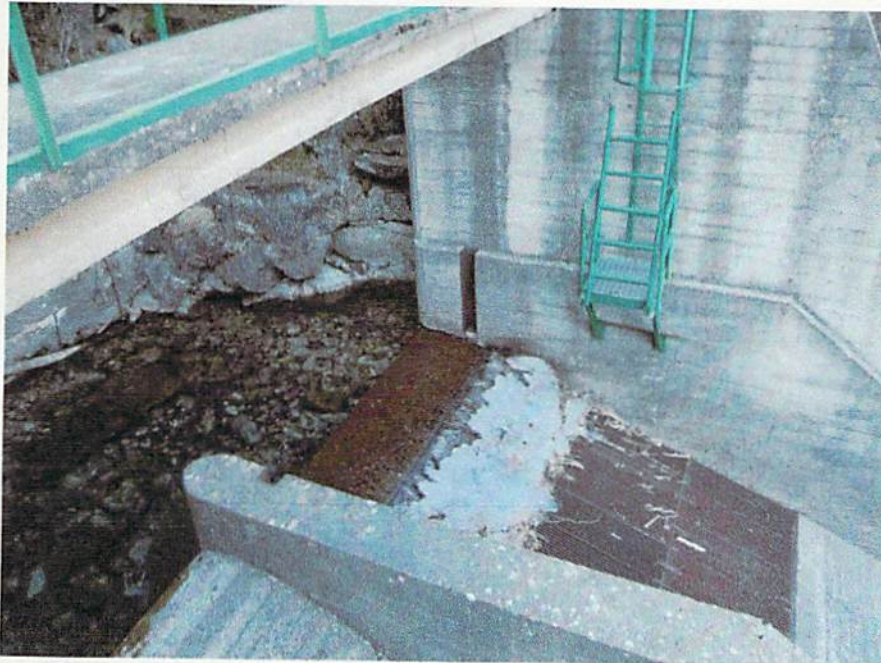
Foto. Entrada de agua en la rejilla a de captación del aprovechamiento hidroeléctrico de Acciona S.A. para la Central de Eriste en el barranco L'Aigueta de la Ball (enero 2012).
